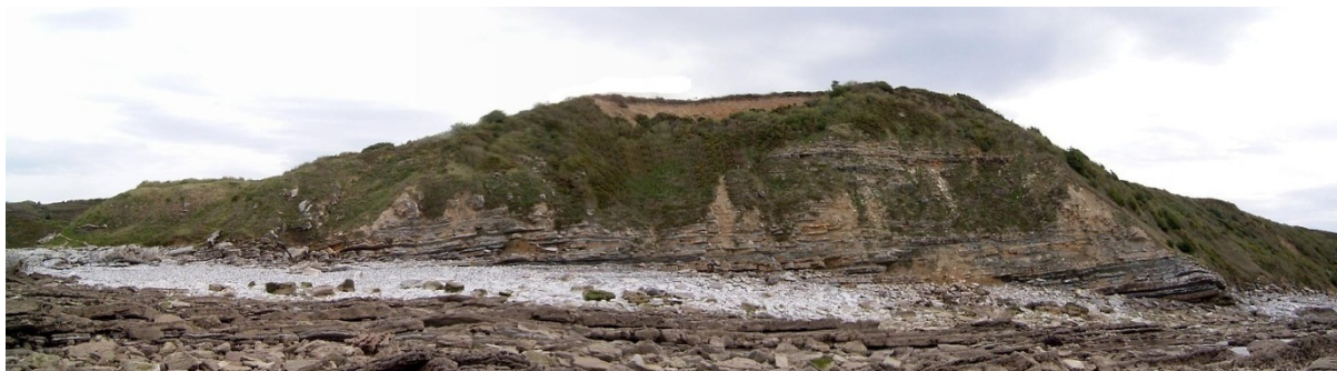
Figure 75 : Cap situé entre Maiarko et Cénix (hauteur : 40 m ; photo du 30/03/2006) : la cicatrice d'un important glissement de terrain récent (postérieur à 2000) apparaît aujourd'hui en sommet de falaise
