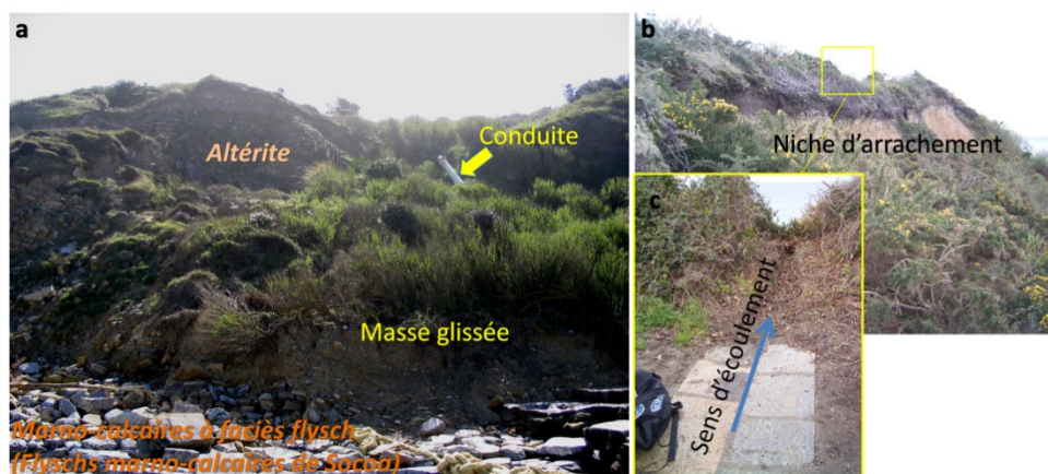
Figure 134: a. Conduite d'eau dans un glissement observé sur le littoral luzien ; b. Escarpement principal d'un glissement sur la commune de Saint-Jean-de-Luz et (c) système de drainage des eaux de pluie du chemin littoral situé dans la zone sommitale, qui les conduit directement en haut du versant
