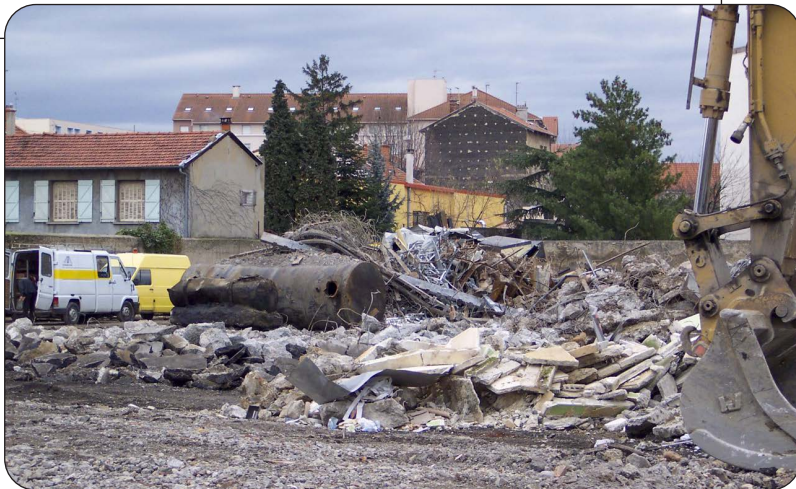
Figure 2.1. Découverte fortuite – par manque d'études préalables – d'une cuve enterrée contenant du fioul résiduel avec pollution des sols périphériques par des hydrocarbures lors des travaux de démolition d'anciens bâtiments industriels en zone urbaine
