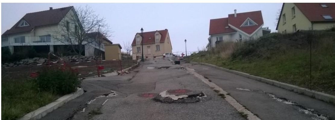
Figure 2 – Dégradations constaté sur les infrastructures (2015)
