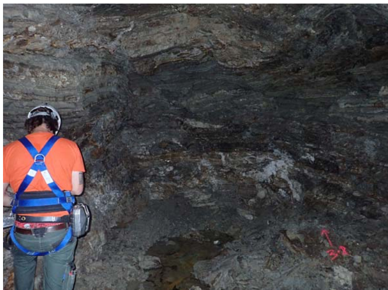
Figure 7 : Cavité au droit de l'enjeu G - Ecoulement d'eau via un ancien sondage
