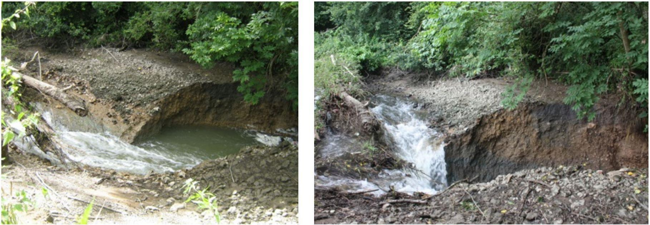
Figure 2 : Bétoire B18262 ouverte dans le lit de la Risle dans la commune d'Ajou en 2012 et ayant provoqué un assec de 12km à l'aval (David et al., 2017)
