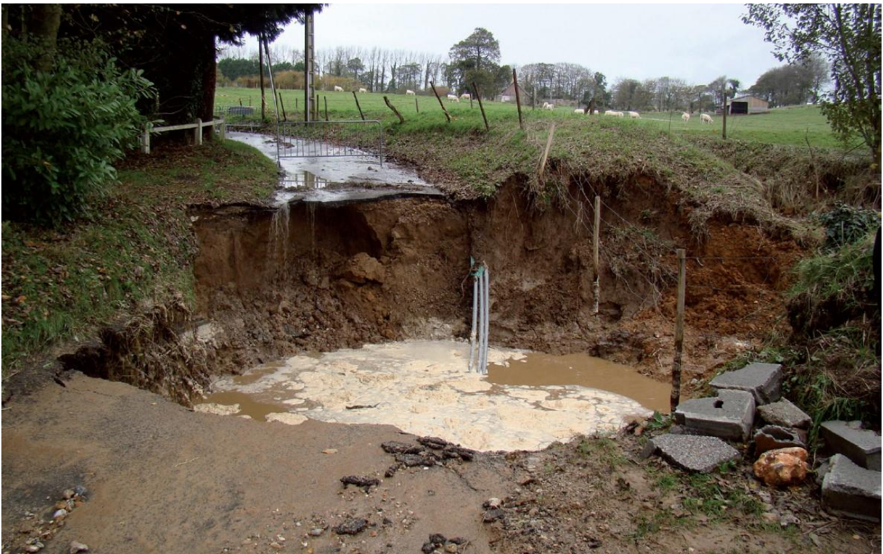
Figure 1 : exemple d'une bétoire ouverte le 04/11/2009 à Saint-Jouin-Bruneval (76) (photo BRGM)
