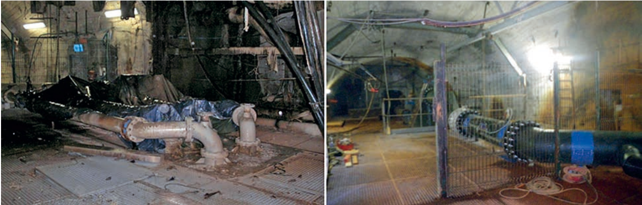
Figure 8 - L'installation de pompage et la canalisation d'évacuation.
