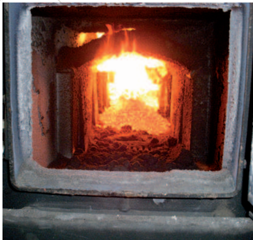
▲ Combustion de pellets de bois dans une chaudière.
