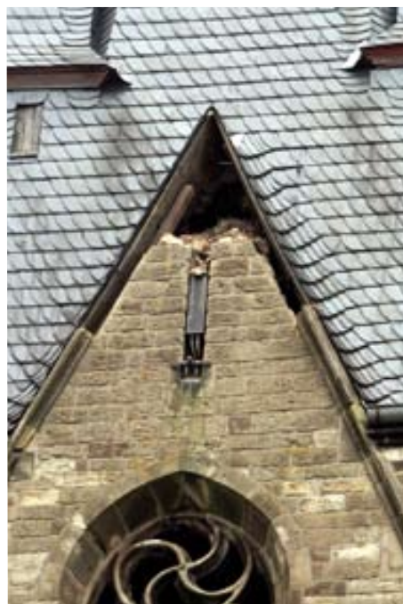
▲ Une partie de l'église Saint-Blaise, Saarwellingen, s'est effondrée le 23 février 2008.
