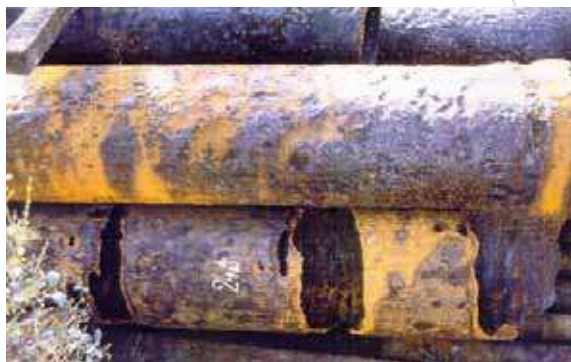
Photo 3 : Tubage en acier (type K55) du forage géothermique de production de Villeneuve-la-Garenne, percé par corrosion. Ce tubage n'assure plus l'étanchéité vis-à-vis des aquifères traversés et peut conduire à une pollution de ceux-ci par le fluide géothermal.
