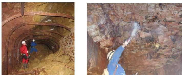
Figure 2 . Visite du fond et marquage des zones instables
