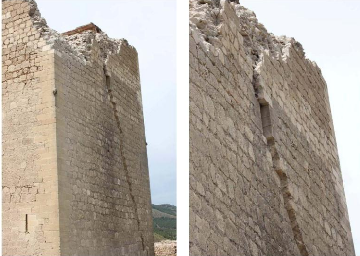
Fig. 11. Paredes del castillo agrietadas en la dirección del movimiento observado, mostrando un desplazamiento de algunos centímetros (IGC, 2011)
